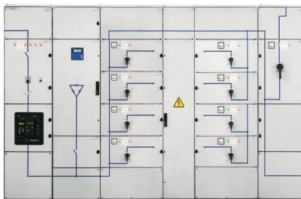
Комплектная трансформаторная подстанция внутренней установки
